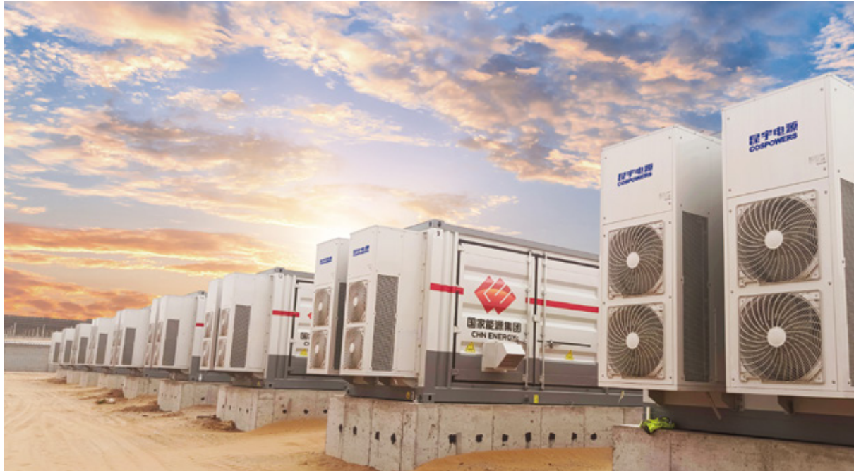
宁夏中卫100MW/200MWh光伏复合储能项目
