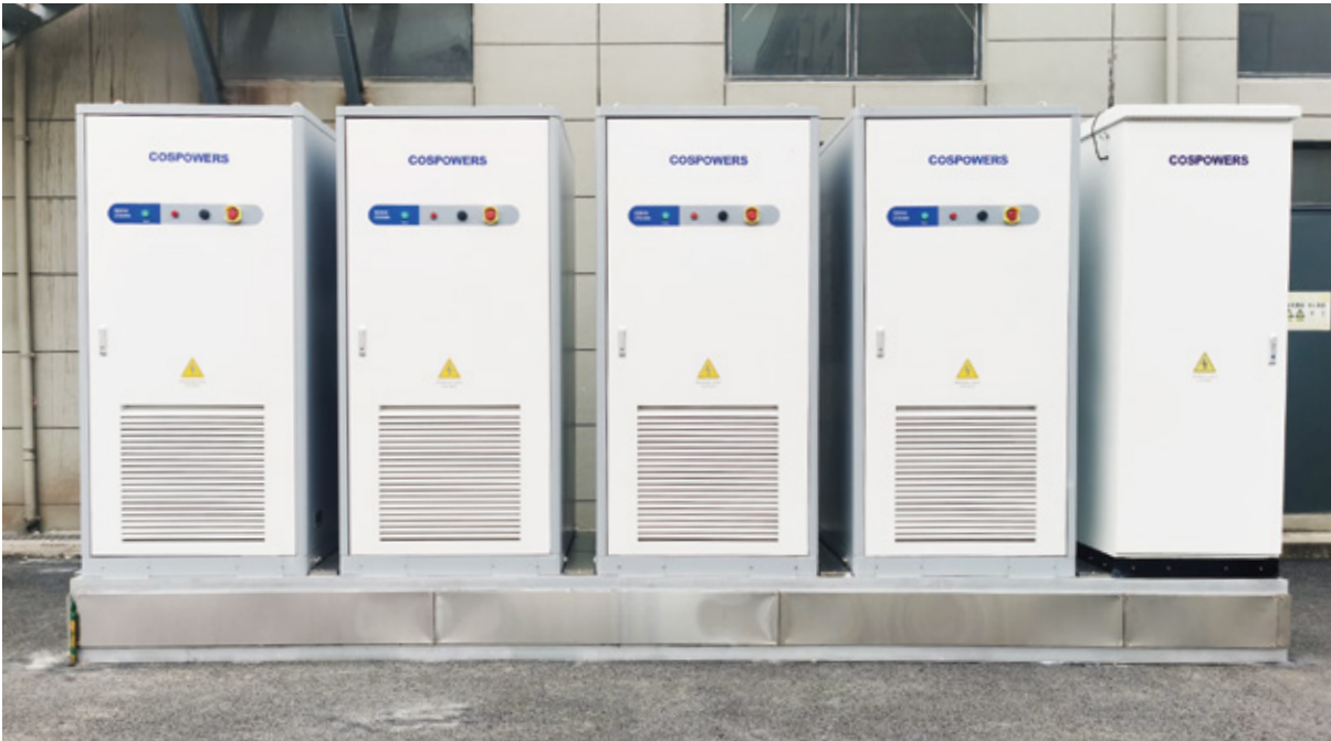
江苏泰兴市某服装水洗工厂工商业储能项目
