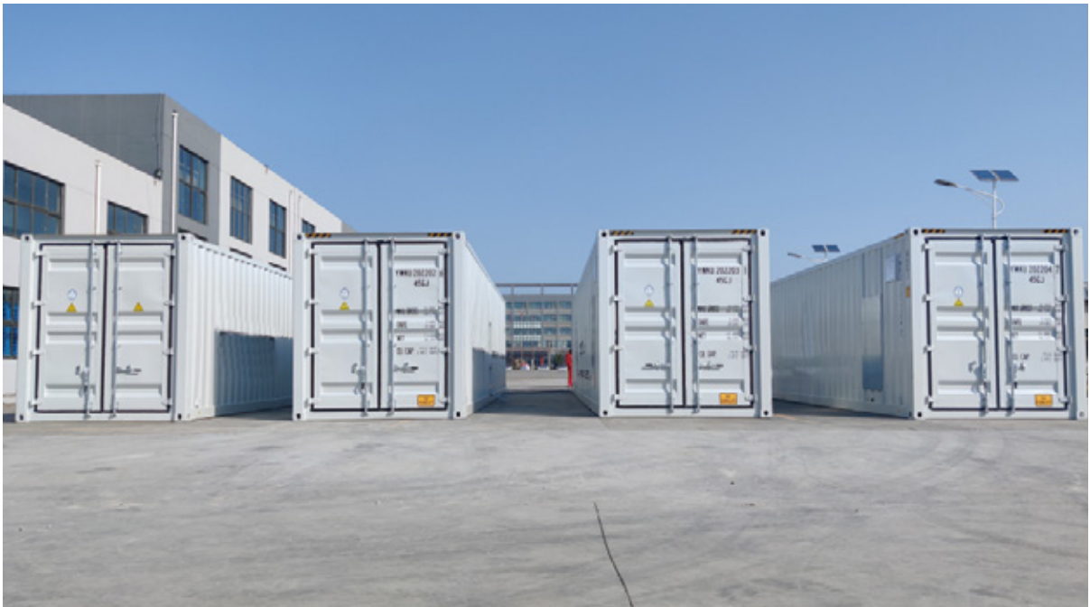
东非区域光伏发电储能项目
