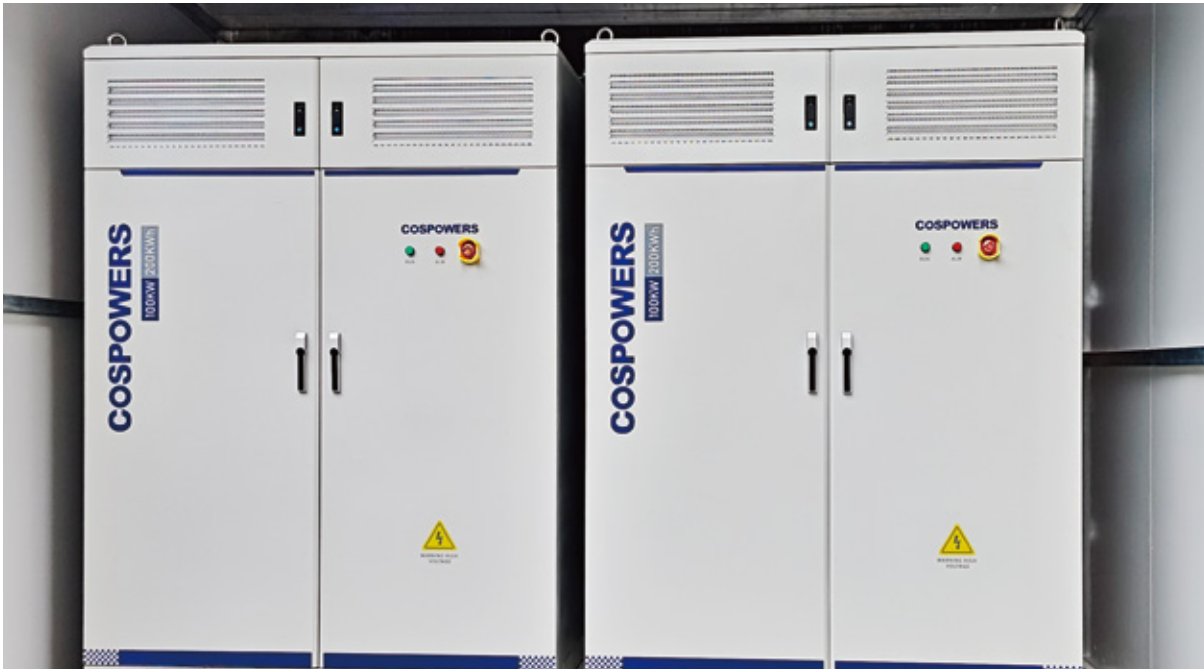
深圳平湖削峰填谷工商业储能项目
