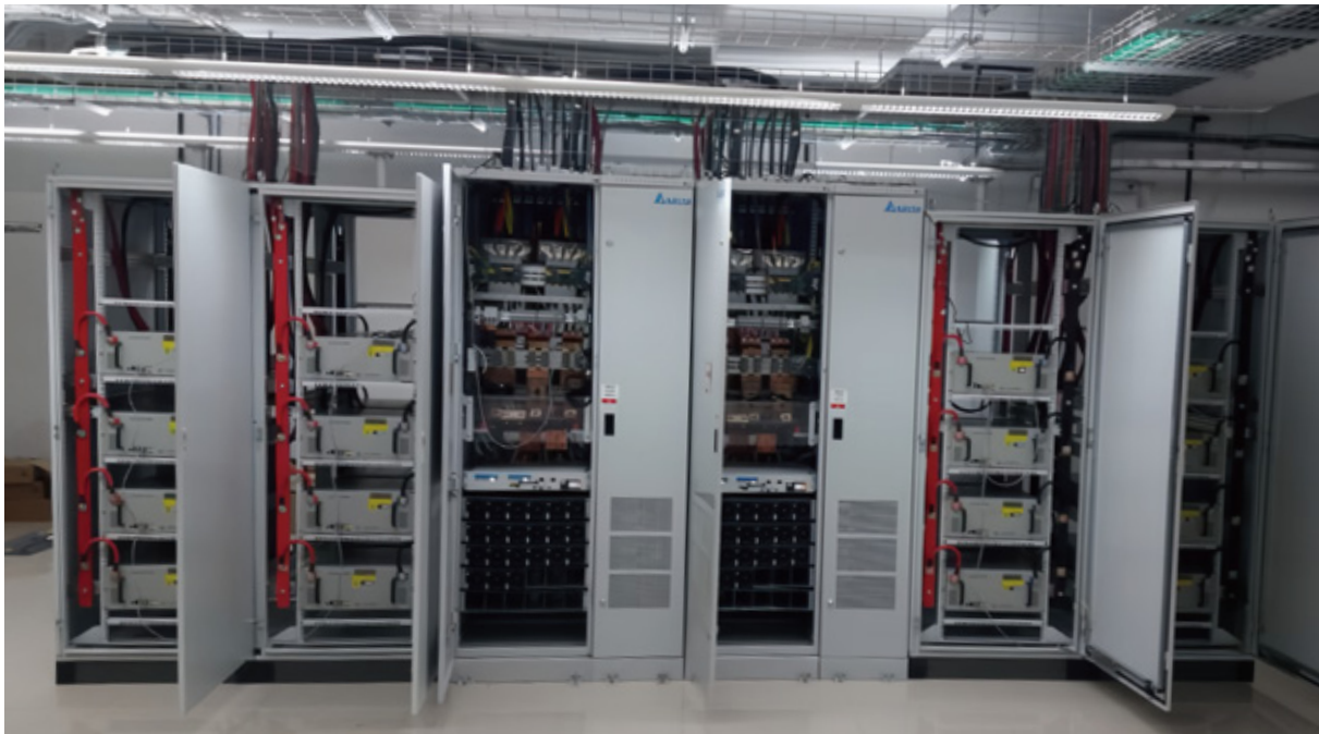
印度信实数据中心项目
