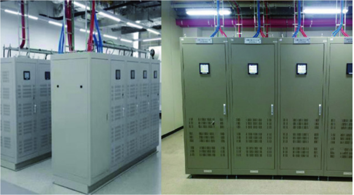
韩国DC数据中心项目
