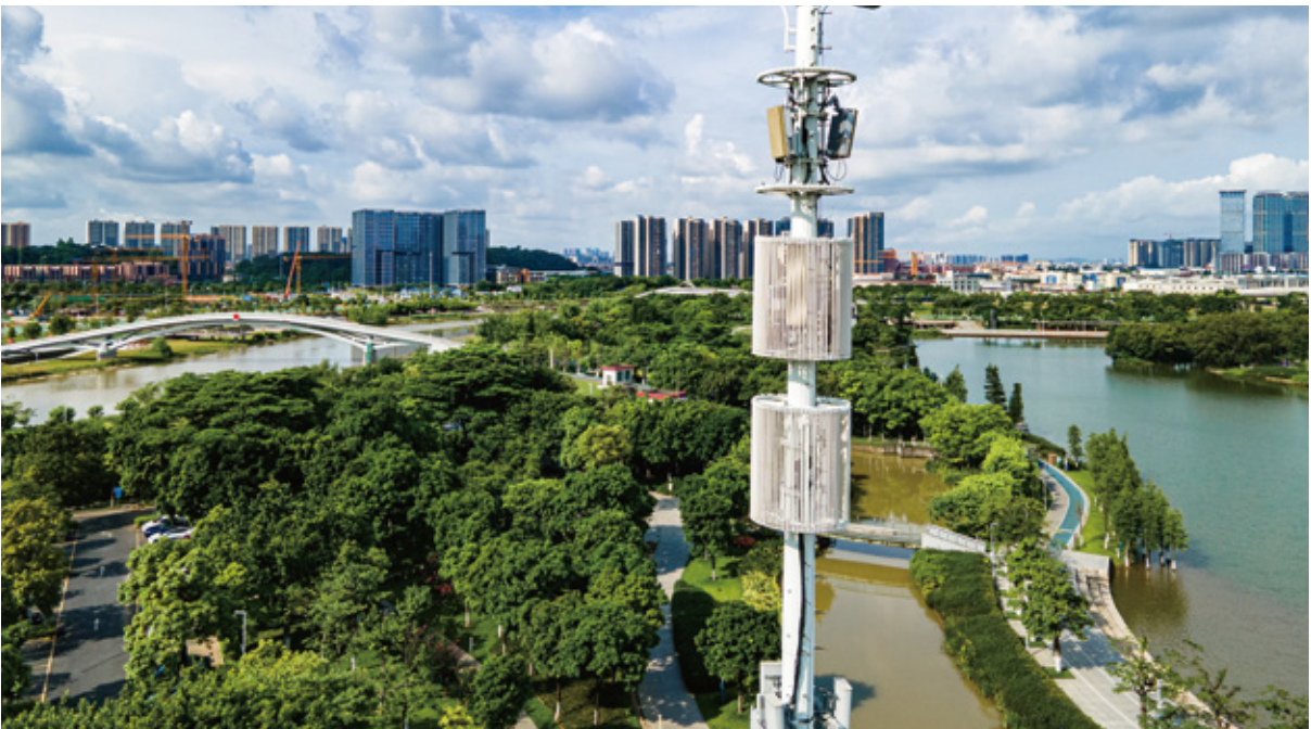
中国铁塔浙江智慧锂电项目 · 应用场景：通信基站 · 项目地点：浙江
