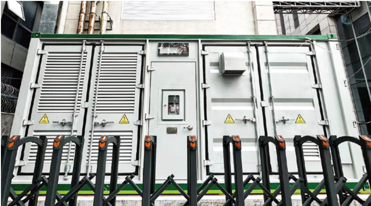
缅甸工商业储能项目 · 应用场景：工商业储能 · 项目地点：缅甸
