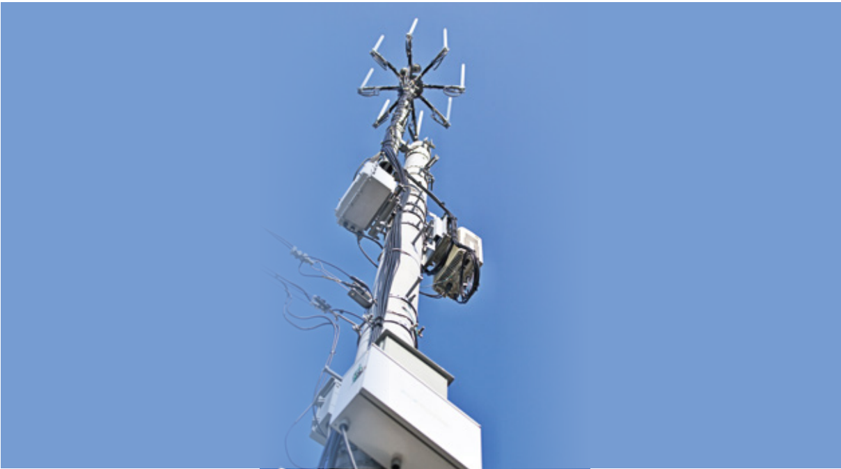
中国移动湖南5G微站一体化项目 · 应用场景：通信基站 · 项目地点：湖南
