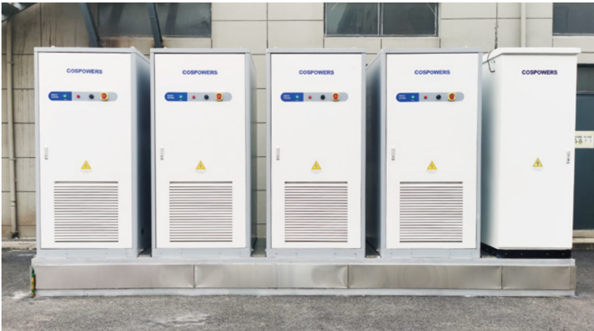
江苏泰兴市某服装水洗工厂工商业储能项目 · 应用场景：工商业储能 · 项目地点：江苏
