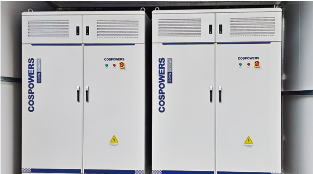
深圳平湖削峰填谷工商业储能项目 · 应用场景：工商业储能 · 项目地点：深圳
