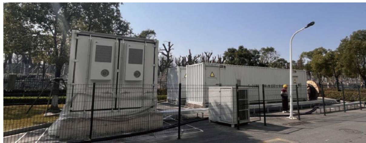
上海移动临港IDC数据中心UPS项目 Shanghai Mobile Lingang IDC Data Center UPS Project
