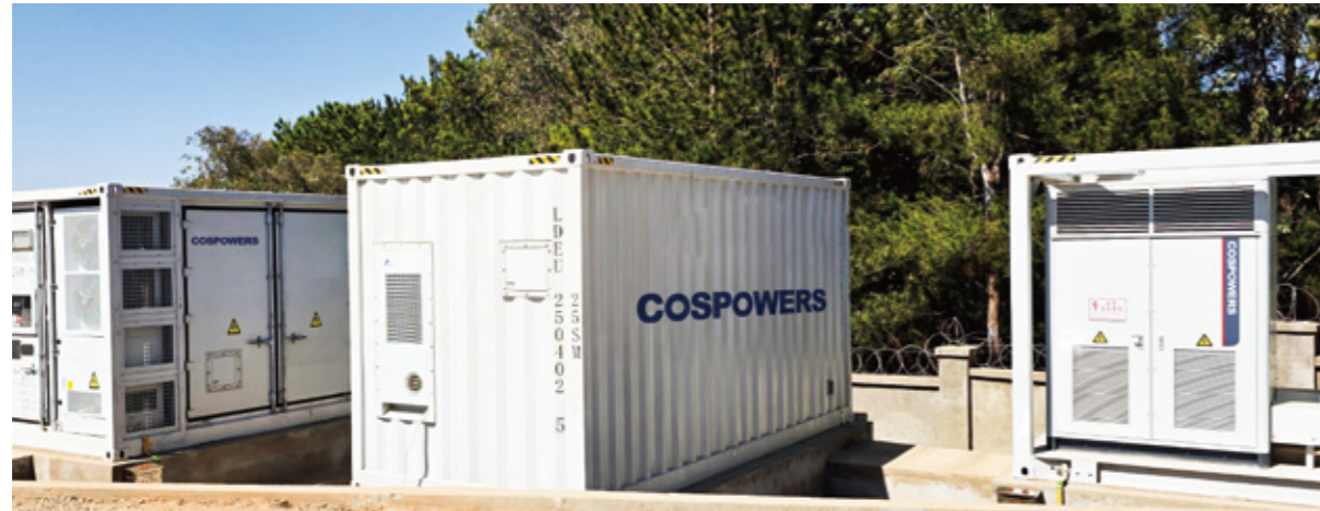
马达加斯加IVATO产业园光储柴一体化智能微电网项目 Madagascar IVATO Industrial Park Integrated Solar-Storage-Diesel Smart Microgrid Project
