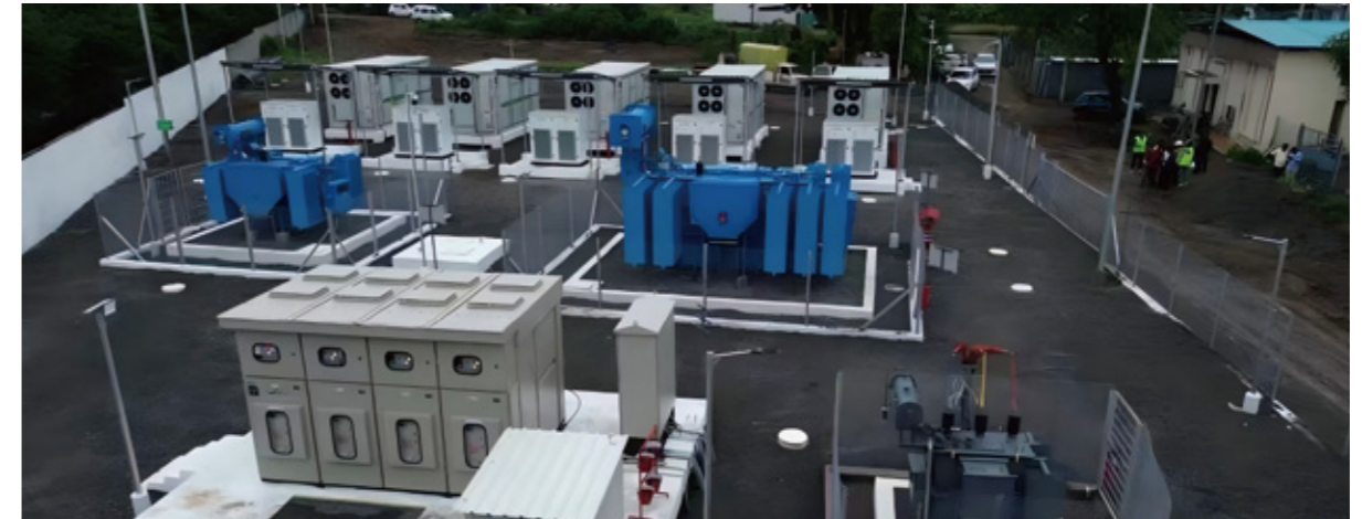
印度11MW/22.99MWh储能项目 11MW/22.99MWh Energy Storage Project in India
