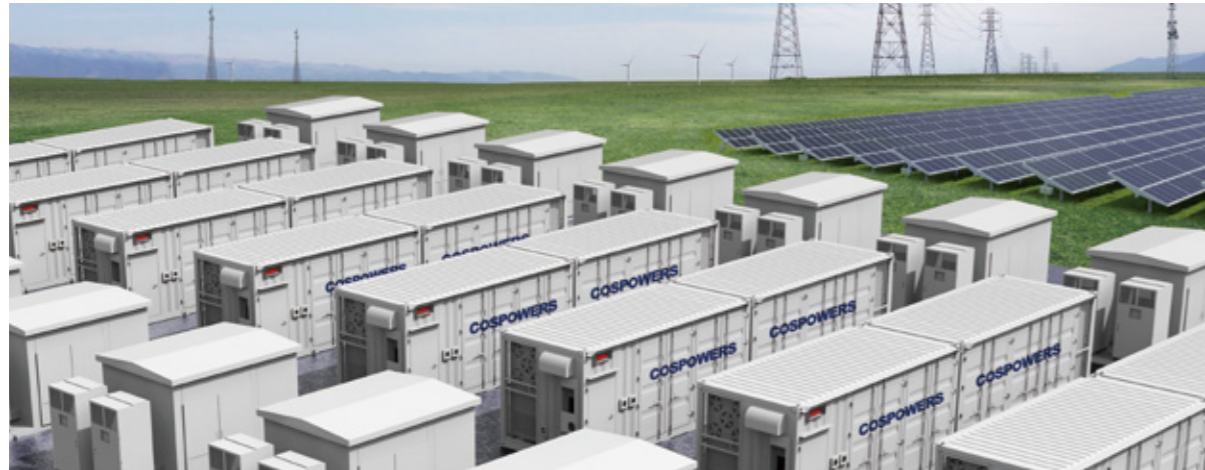
保加利亚200MW/800MWh电池储能系统项目 Bulgaria 200MW/800MWh Battery Energy Storage System (BESS) Project
