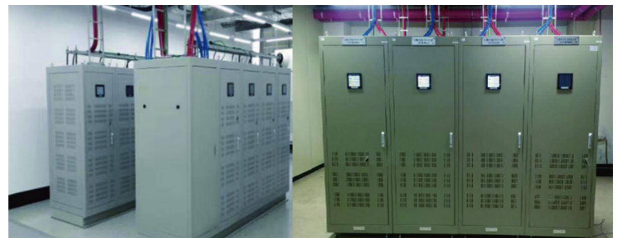
韩国IDC数据中心项目 South Korea IDC Data Center Project
