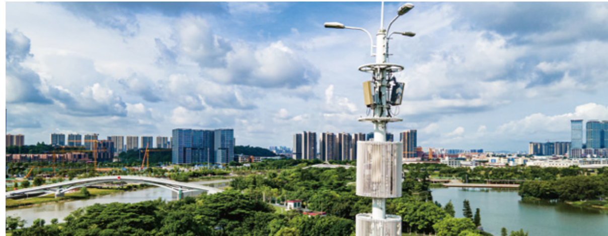
中国铁塔浙江智慧锂电项目 China Tower Zhejiang Smart Lithium Project
