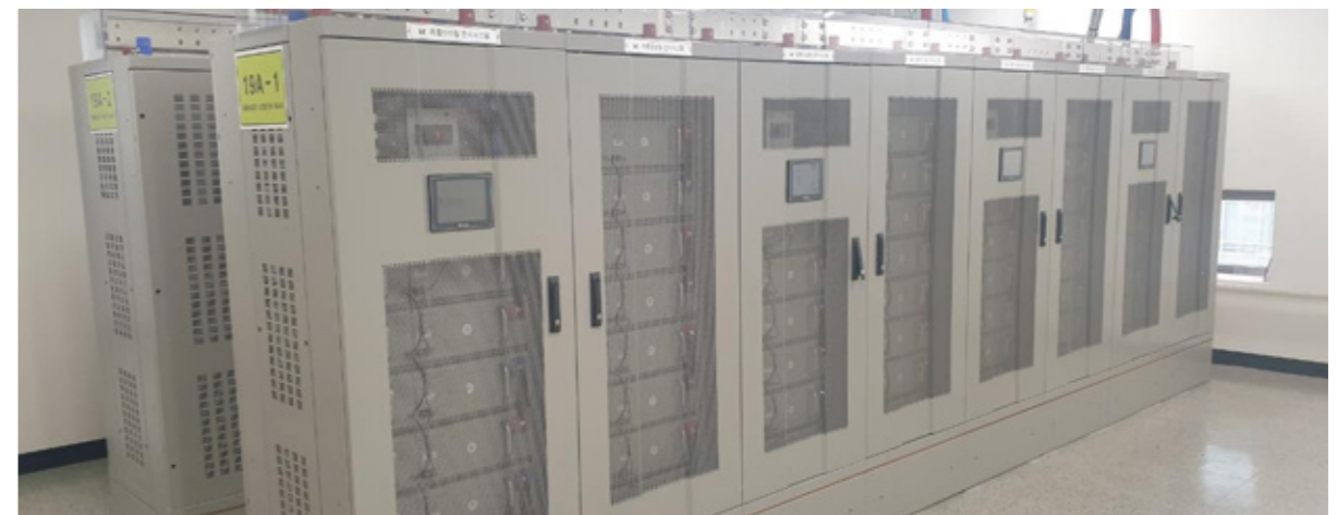
韩国青州数据中心UPS备电锂电池 South Korea Cheongju Data Center UPS Backup Lithium
