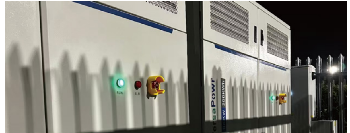
苏格兰工商业储能项目 Scotland Commercial & Industrial Energy
