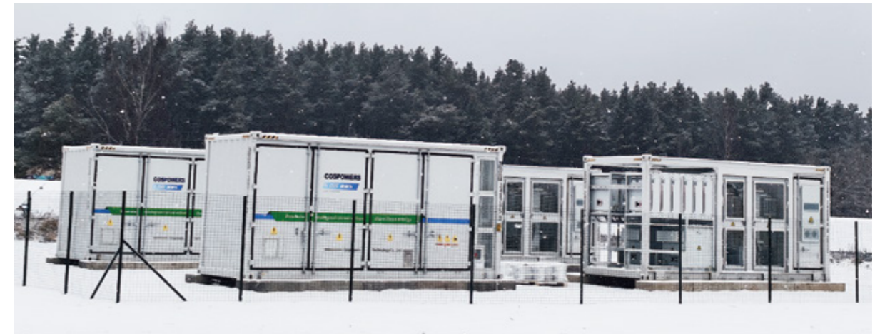
拉脱维亚5MW/10MWh 储能系统项目 Latvia 5MW/10MWh Energy Storage System Project
