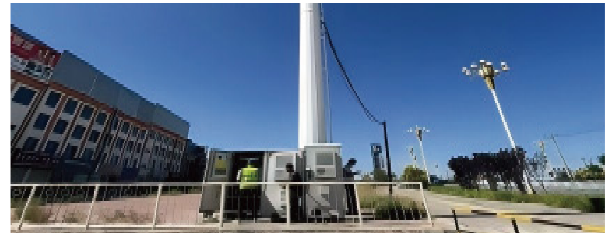
中国铁塔甘肃智慧钠电项目 China Tower Gansu Smart Sodium Battery Project
