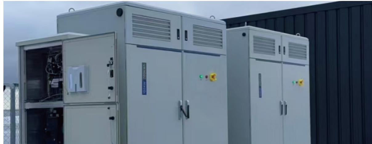
挪威工商业储能项目 Norway Commercial & Industrial Energy
