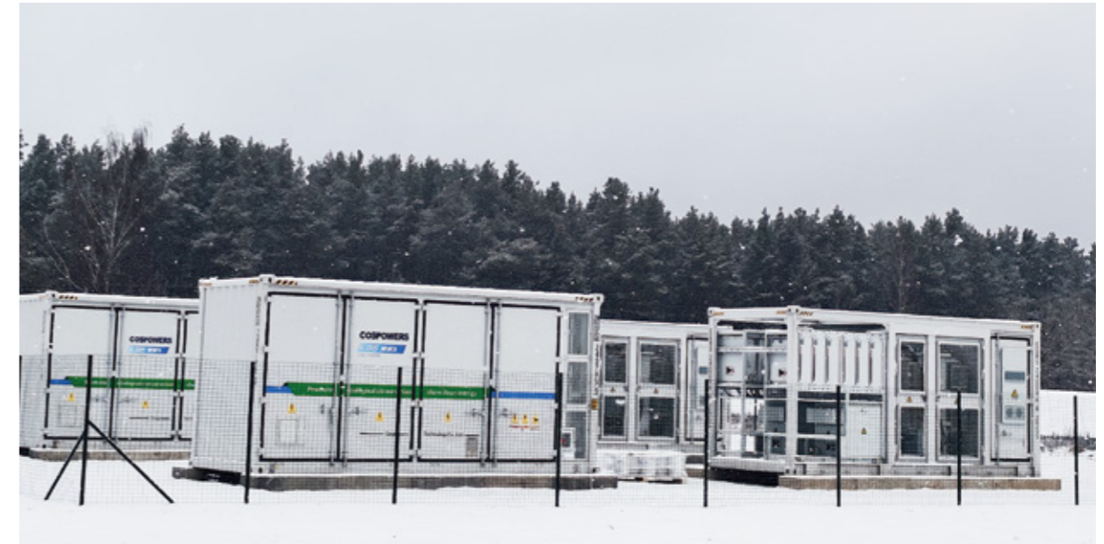
拉脱维亚5MW/10MWh储能系统项目 项目时间: 2025年 项目地点: 拉脱维亚 项目特色: 方案定制化、削峰填谷、辅助服务
