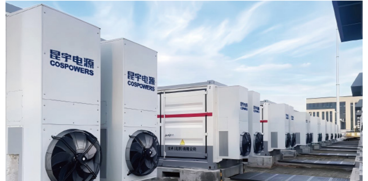
安徽天长200MW渔光互补发电87.5MW/175MWh储能项目 项目时间: 2023年 项目地点: 安徽天长 项目特色: 灵活控制电网供应, 改善电能质量
