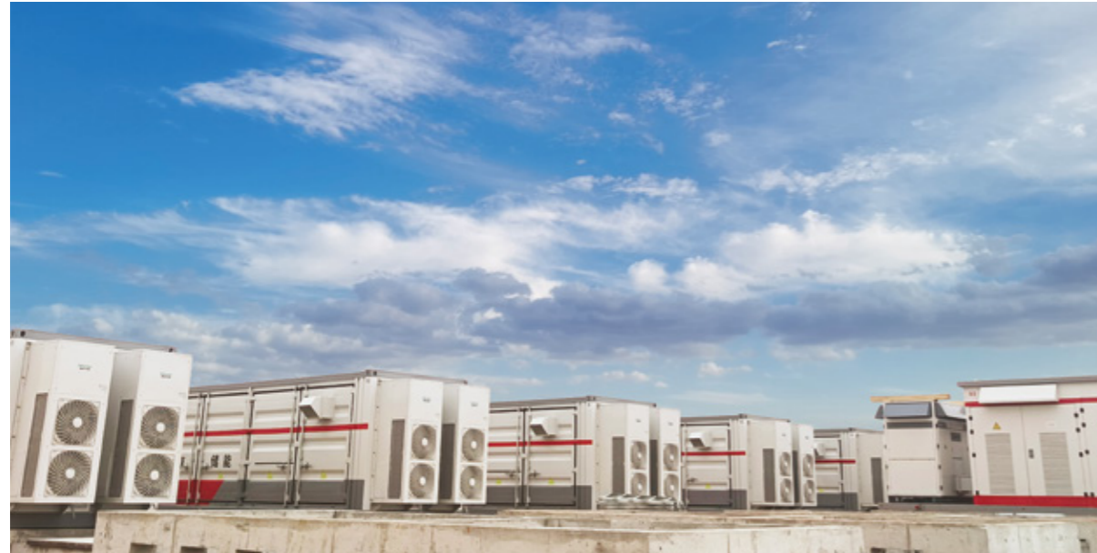
宁夏银川200MW/800MWh储能项目 项目时间: 2025年 项目地点: 宁夏银川 项目特色: 创新治沙经济, 赋能宁夏绿色低碳发展
