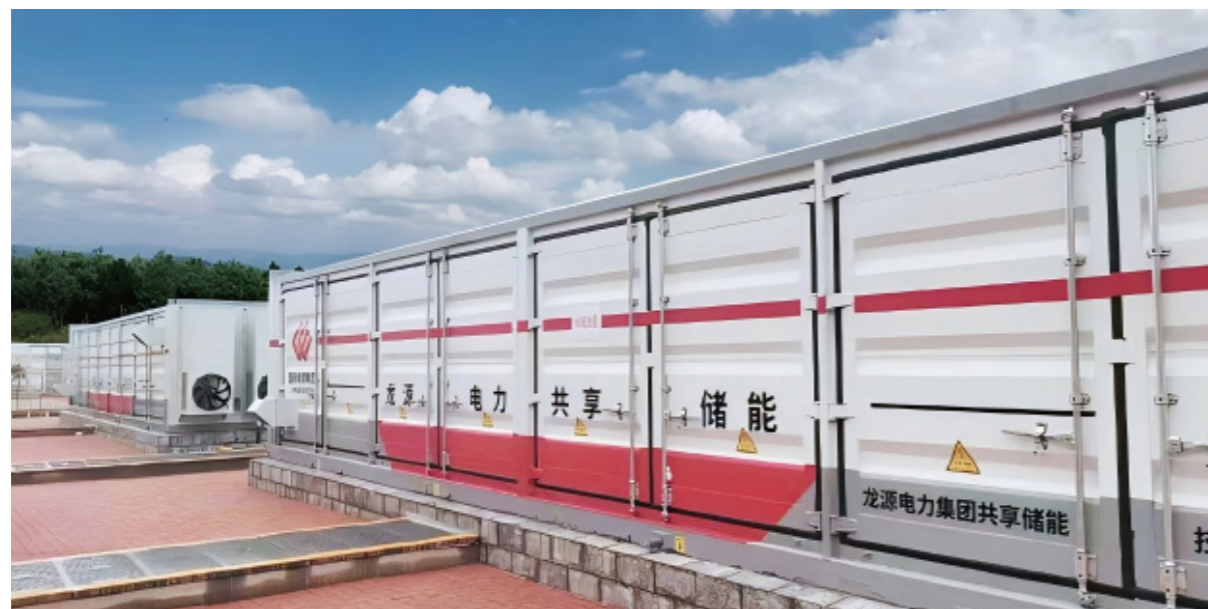
贵州威宁80MW/160MWh风能发电储能项目 项目时间: 2023年 项目地点: 贵州威宁 项目特色: 促进新能源消纳, 增强电网稳定性
