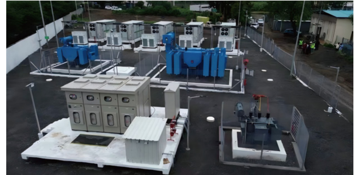
印度11MW/22.99MWh储能项目 项目时间: 2025年 项目地点: 印度 项目特色: 风电配储能, 平滑出力
