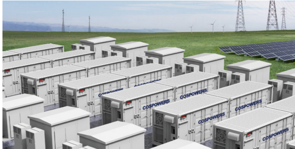
保加利亚200MW/800MWh电池储能系统项目 项目时间: 2025年 项目地点: 保加利亚 项目特色: 超大容量、削峰填谷、支撑欧洲电网
