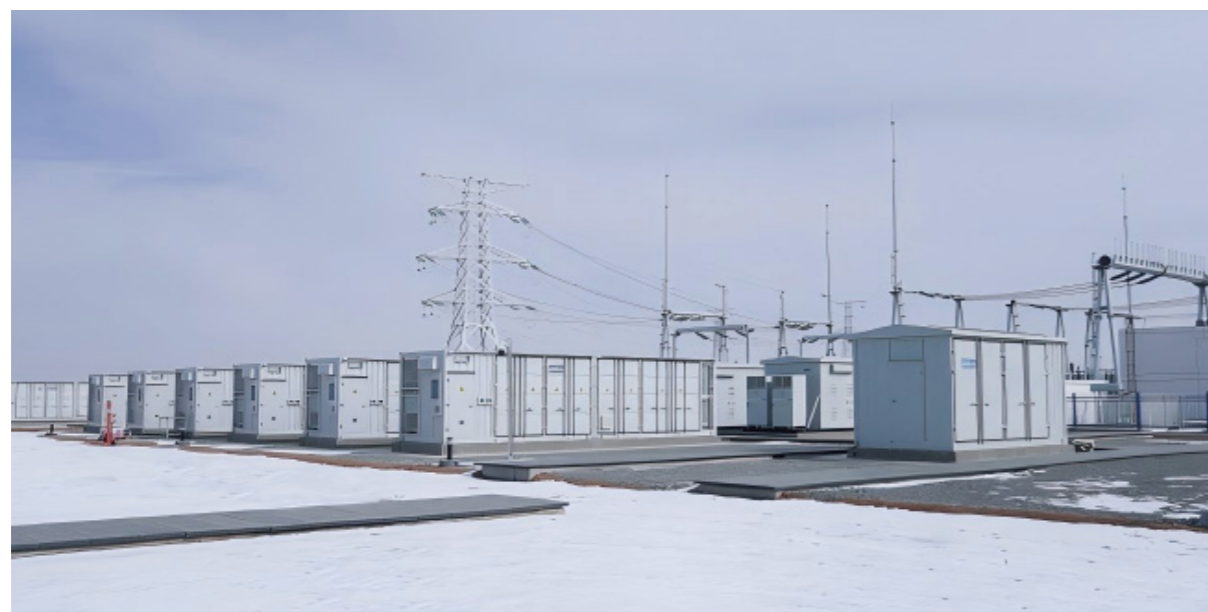
甘肃临泽500MW光伏治沙发电40MW/80MWh储能项目 项目时间: 2022年 项目地点: 甘肃临泽 项目特色: 项目灵活控电, 调节电网拐点, 平抑功率波动
