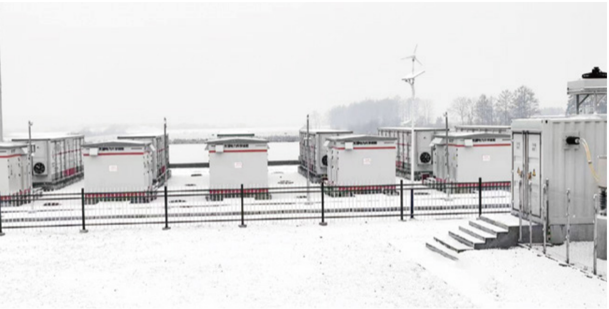
黑龙江伊春铁力年丰20MW风力发20MW/40MWh电储能项目 项目时间: 2024年 项目地点: 黑龙江伊春 项目特色: 风电配储、电网支撑
