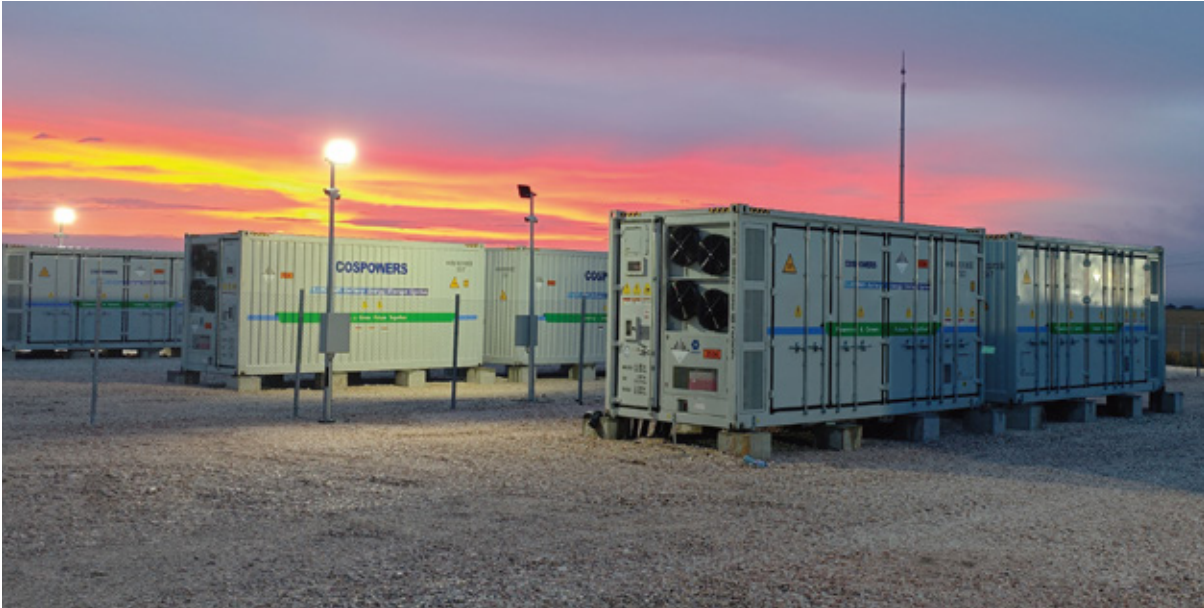
保加利亚200MW/800MWh电池储能系统项目
