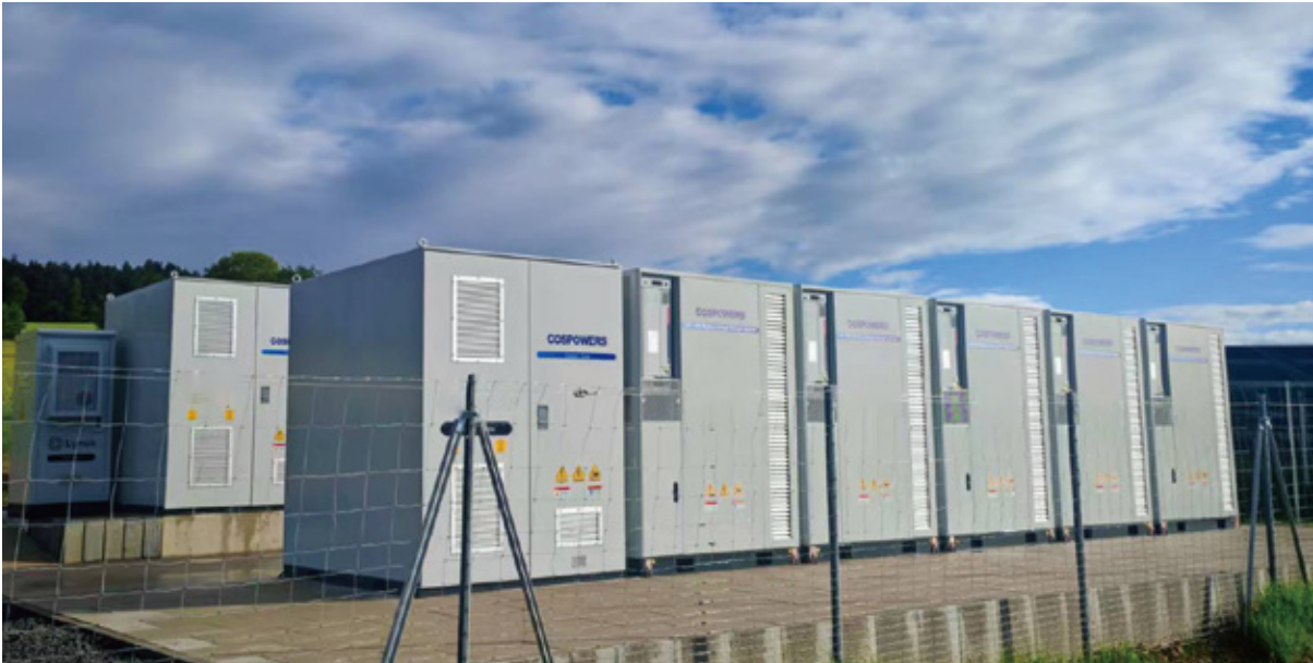
德国12MW/10.02MWh储能项目
