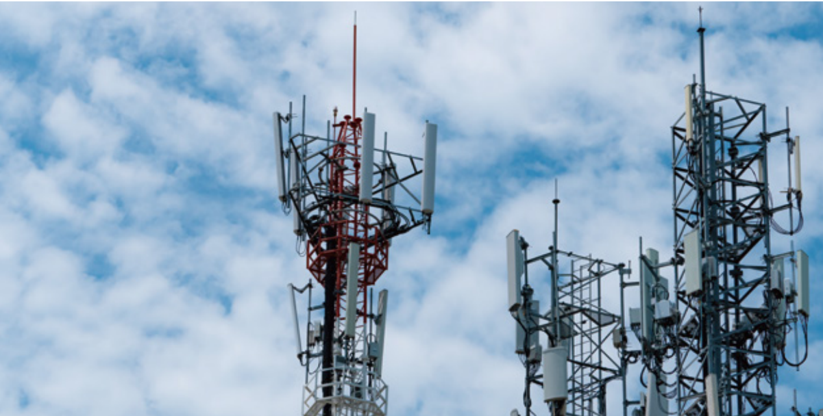
中国移动湖南5G微站一体化项目 项目时间：2022年 项目地点：湖南
