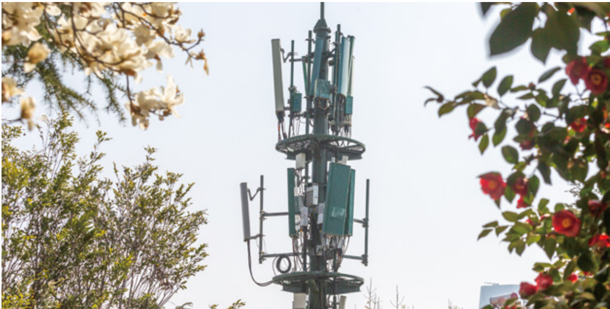
韩国KT电信基站项目 项目时间: 2022年 项目地点: 韩国
