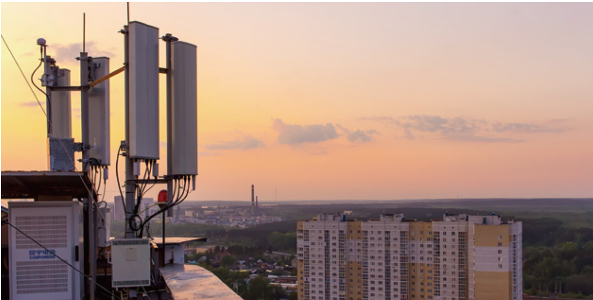
中国移动基站备电项目 项目时间: 2022年 项目地点: 黑龙江, 湖北, 湖南等
