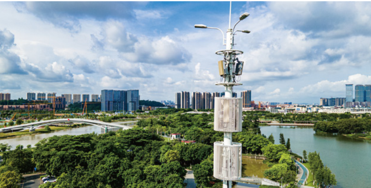
中国铁塔浙江智慧锂电项目 项目时间：2023年 项目地点：浙江
