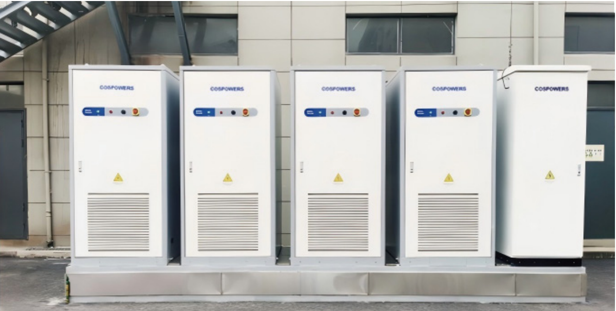
江苏泰兴市某服装水洗工厂工商业储能项目 项目时间: 2024年 项目地点: 江苏
