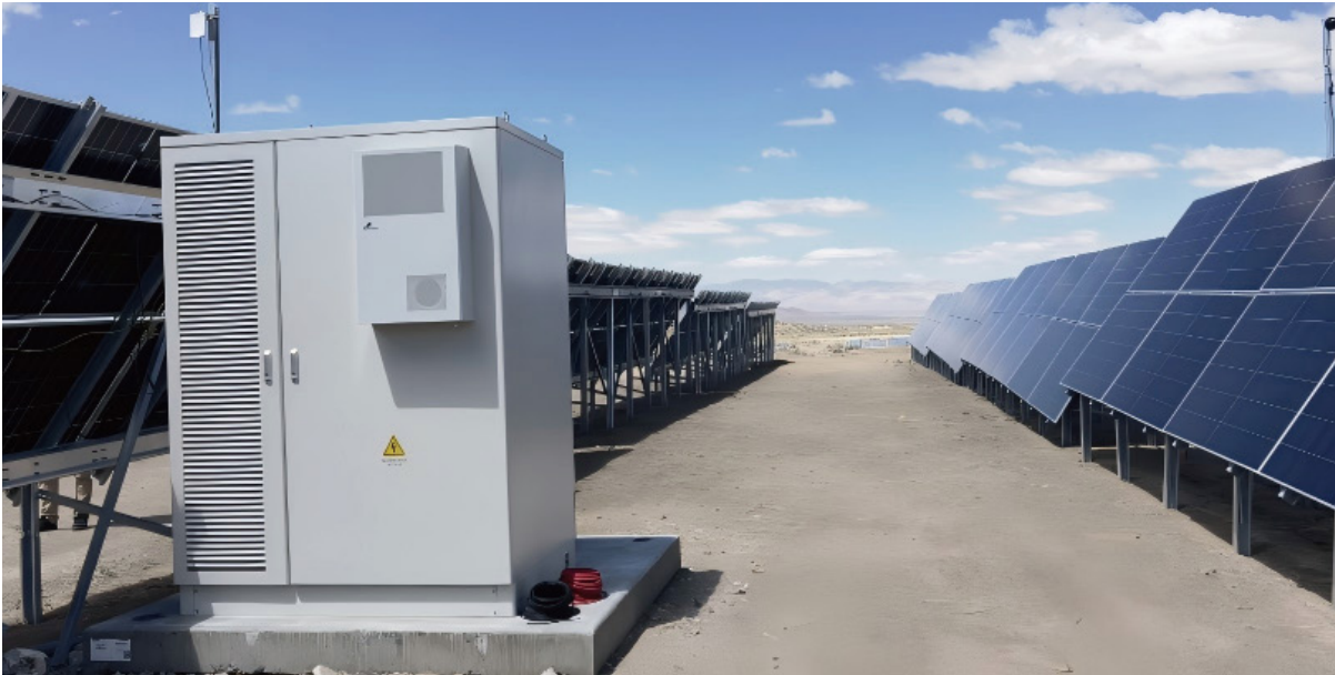
储能+光伏一体化运算服务器备电电源系统解决方案 项目时间: 2024年 项目地点: 美国
