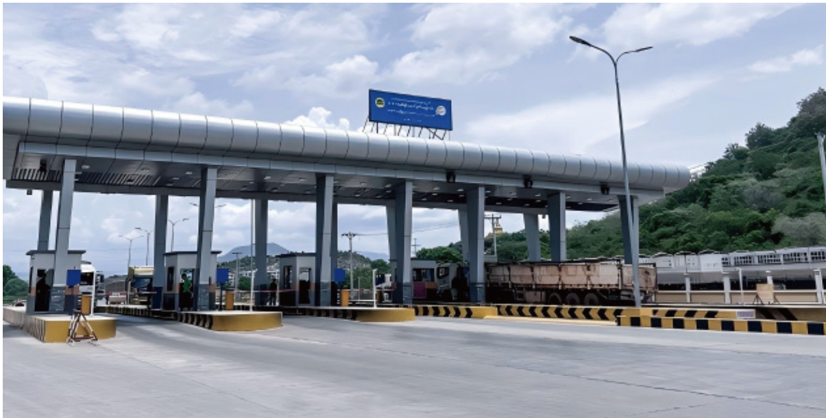
缅甸曼德勒SKG收费站工商业储能项目 项目时间: 2023年 项目地点: 缅甸
