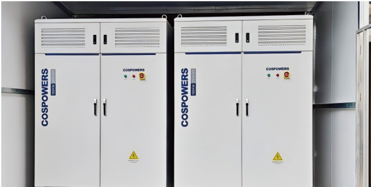
深圳平湖削峰填谷工商业储能项目 项目时间: 2024年 项目地点: 广东
