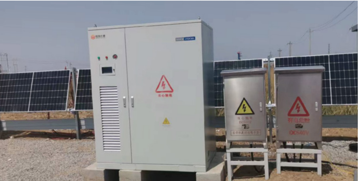
储能+光伏+风电+直流配电与柔性控制技术的能源系统解决方案 项目时间: 2025年 项目地点: 山东
