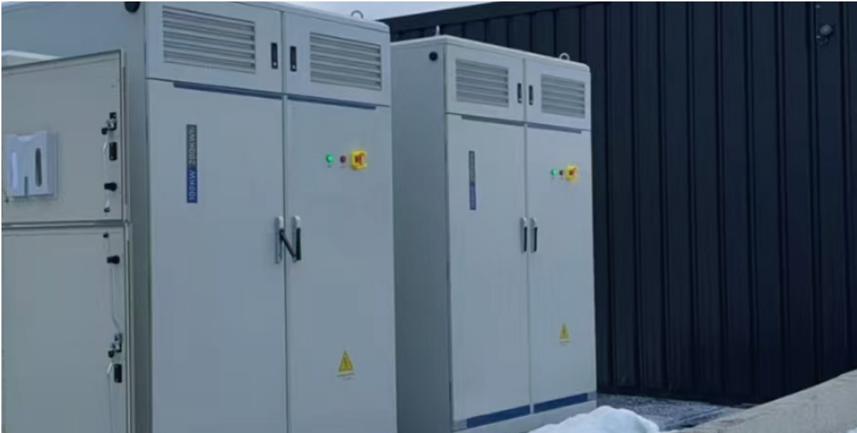
挪威工商业储能项目 项目时间: 2024年 项目地点: 挪威
