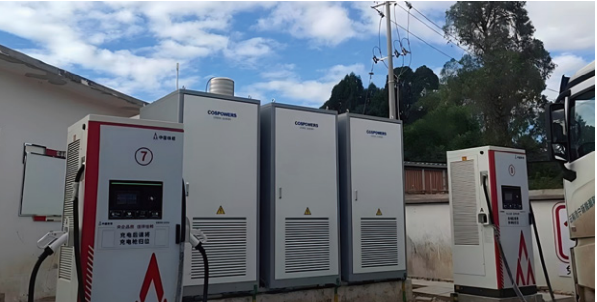
昆明石林北大村重卡充电站储能项目 项目时间: 2025年 项目地点: 云南
