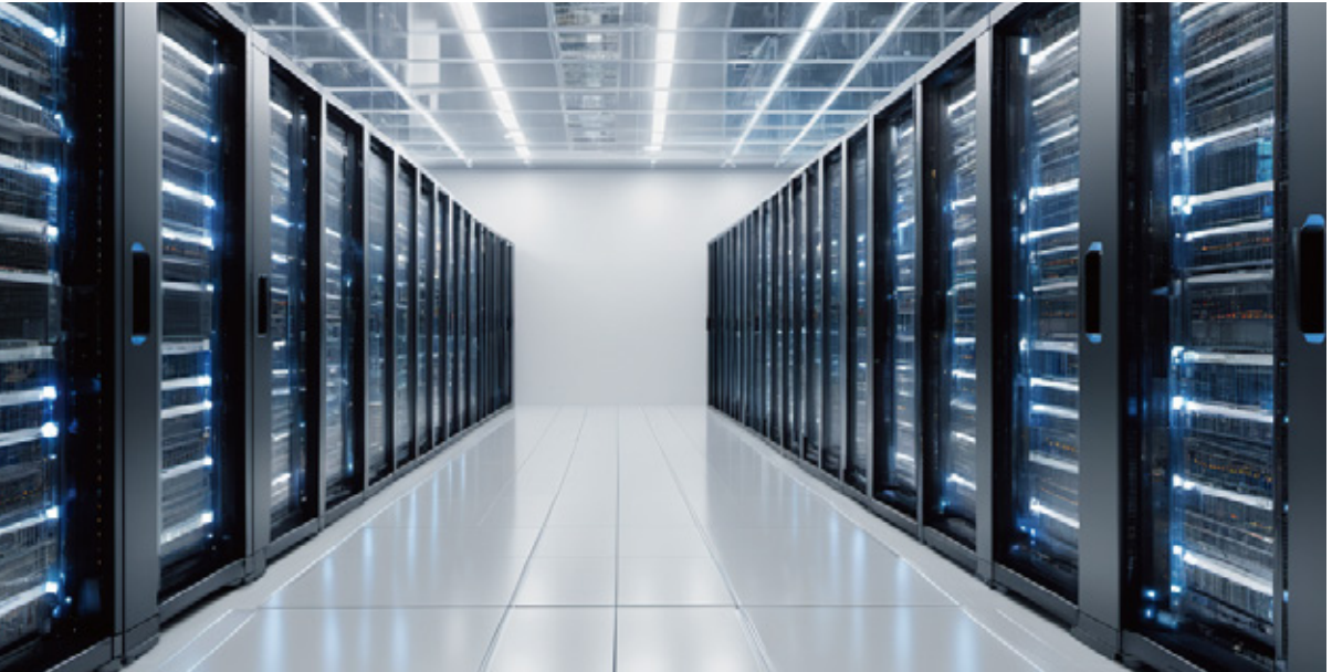
中国联通山西数据中心项目 项目时间: 2022年 项目地点: 山西
