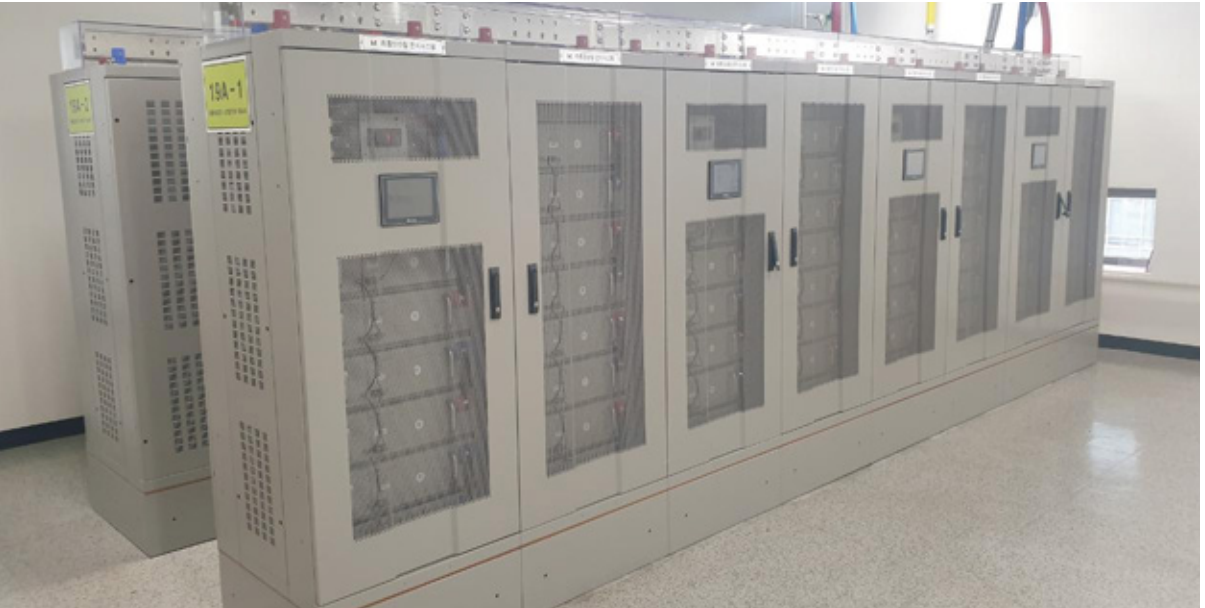
韩国青州数据中心UPS备电锂电池 项目时间: 2021年 项目地点: 韩国
