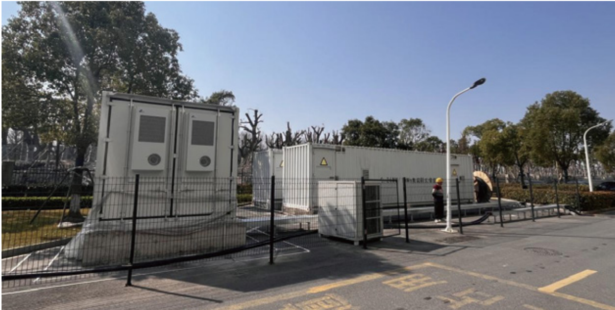
上海移动临港IDC数据中心UPS项目 项目时间: 2025年 项目地点: 上海
