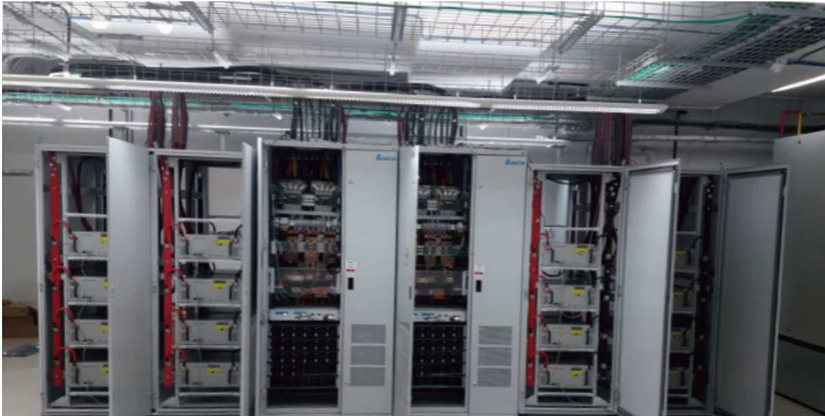
印度信实数据中心项目
