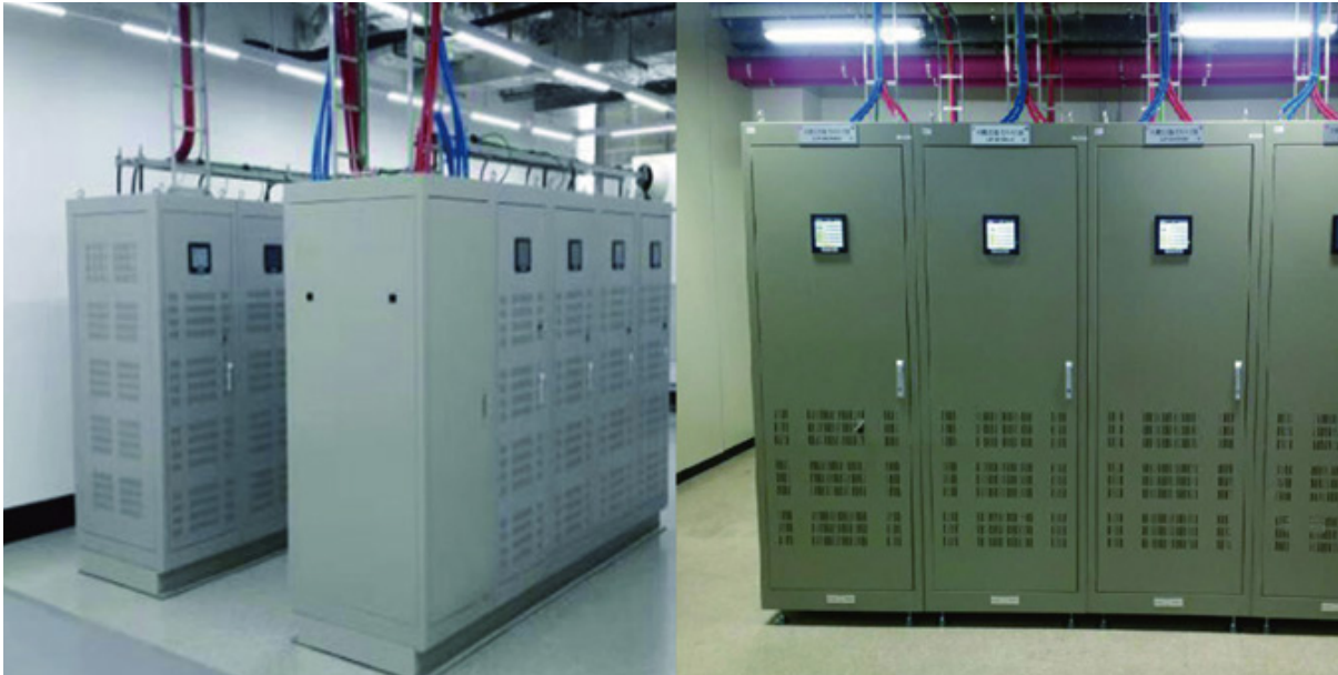
韩国IDC数据中心项目
