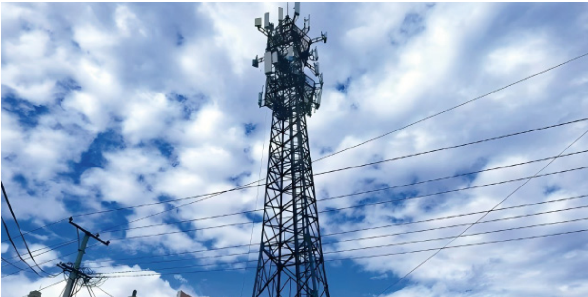
中国移动黑龙江智慧钠电项目 项目时间: 2024年 项目地点: 黑龙江黑河
