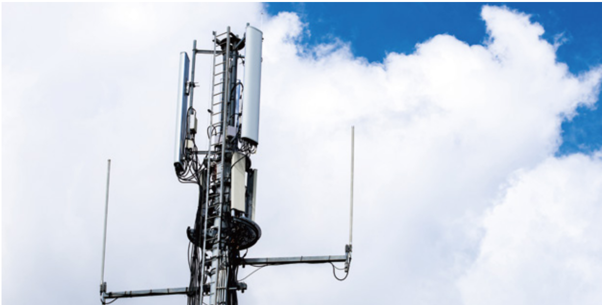
中国铁塔黑龙江智慧钠电项目 项目时间: 2024年 项目地点: 黑龙江七台河
