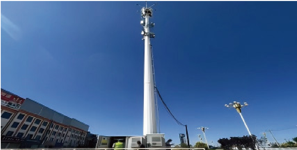
中国铁塔甘肃智慧钠电项目 项目时间: 2024年 项目地点: 甘肃天水
